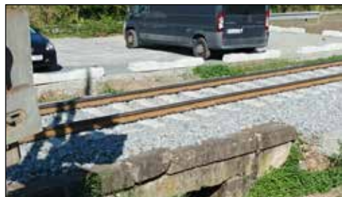
Propustek, na který nikdo nesáhl, i když vše dokola je nové. Kdy se do trati začne znovu kopat kvůli opravě tohoto propustku?
