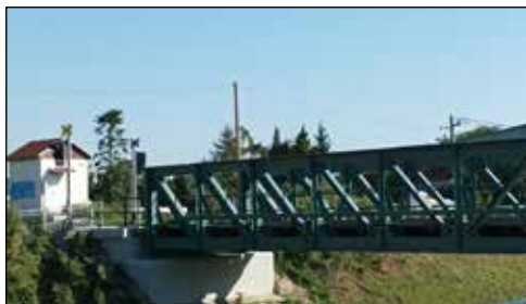
Most přes řeku Olšavu mezi žst. Kunovice zastávka a žst. Uherské Hradiště po dokončení opravy.
