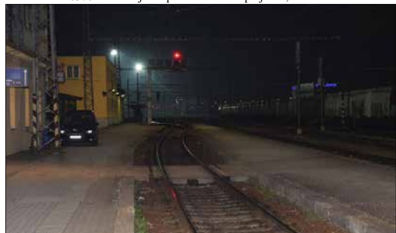
Cestové návěstidlo Lc5b na krakorci
