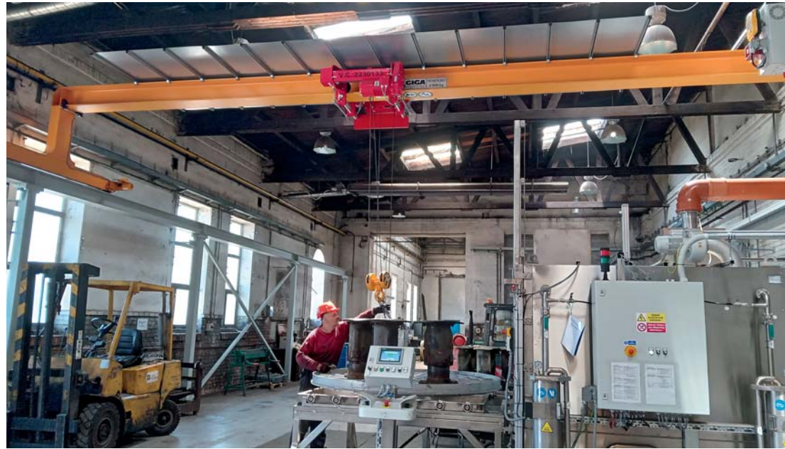
Nový mostový jeřáb
